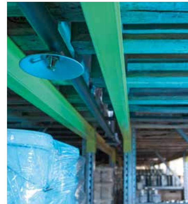
L'entreprise est équipée d'un système moderne de sprinklers.
